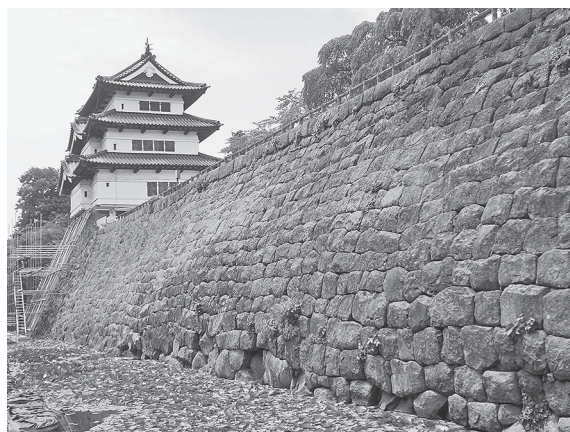
本丸東面石垣の はら 孕みと天守（平成26年11月）
