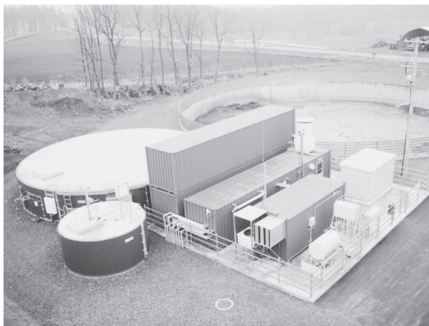
バイオガスプラント
