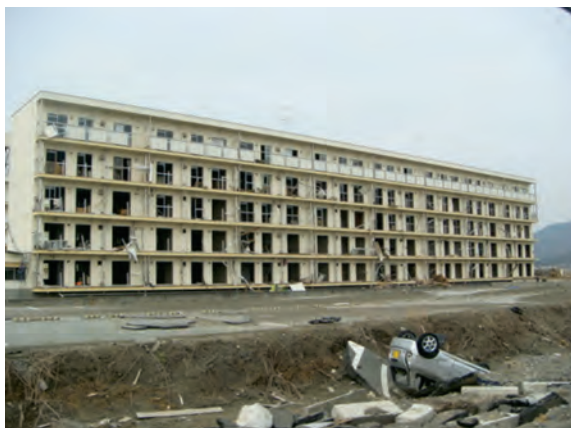
4階まで浸水した陸前高田市の市営住宅 (撮影：日本政策投資銀行地域企画部)
