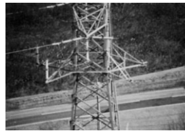
送電線設備点検
